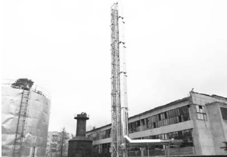
Котельная в г. Ликино-Дулево
